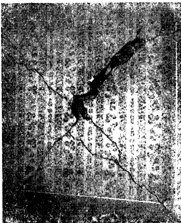
Obr. 3. Křížové trhliny jako důsledek horizontálního pohybu v rovině zdi. Zemětřesení v Kraňsku 1917. (Archiv Stát. ústavu geofysikálního.)
